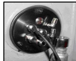
Isıtma/soğutma cihazları sızdırmazlık
